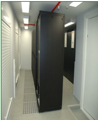
4. Шкафы с оборудованием
